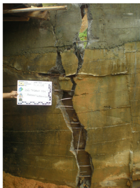
Figura 8 – Avaria em estrutura de contenção
