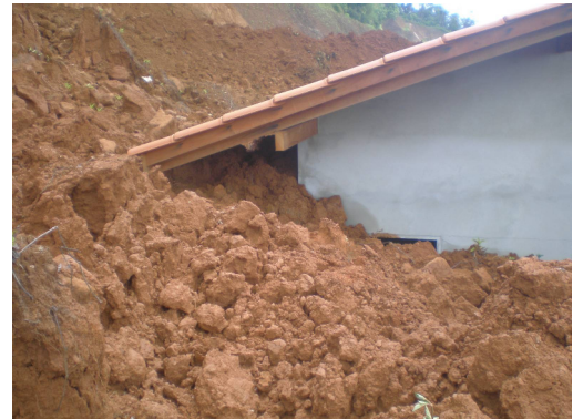
Figura 7 – Soterramento de edificação
