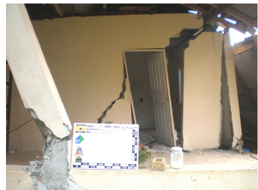
Figura 9 – Avaria grave em edificação
