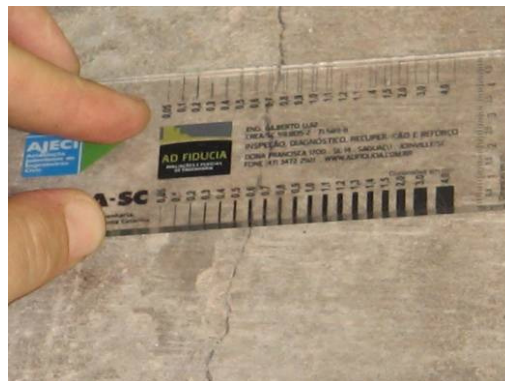
Figura 4 – Cadastramento de fissuras
