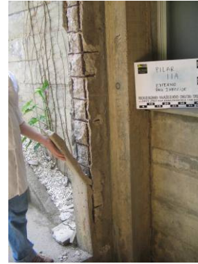
Figura 9 – Deslocamentos em pilares
