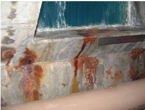
Figura 10 – Padrão de manchamentos – face externa da piscina – Contaminação por cloretos
