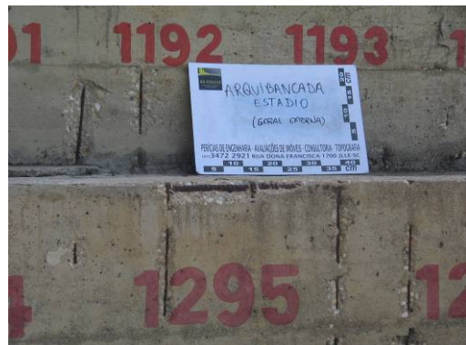
Figura 13 – Deslocamentos em arquivancadas
